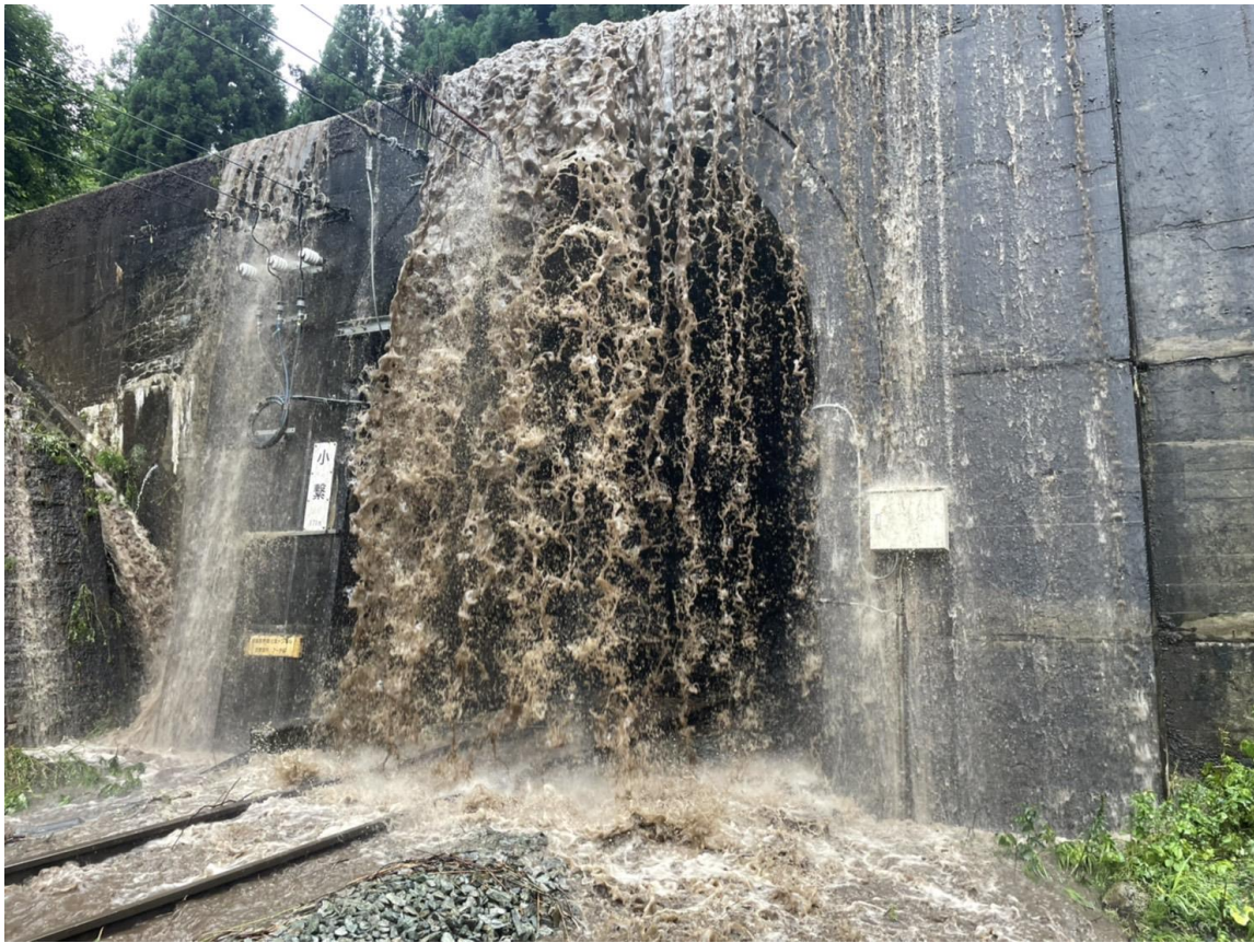
①小繫－小鳥谷間 小繫トンネル：トンネル内へ水が流入している様子
