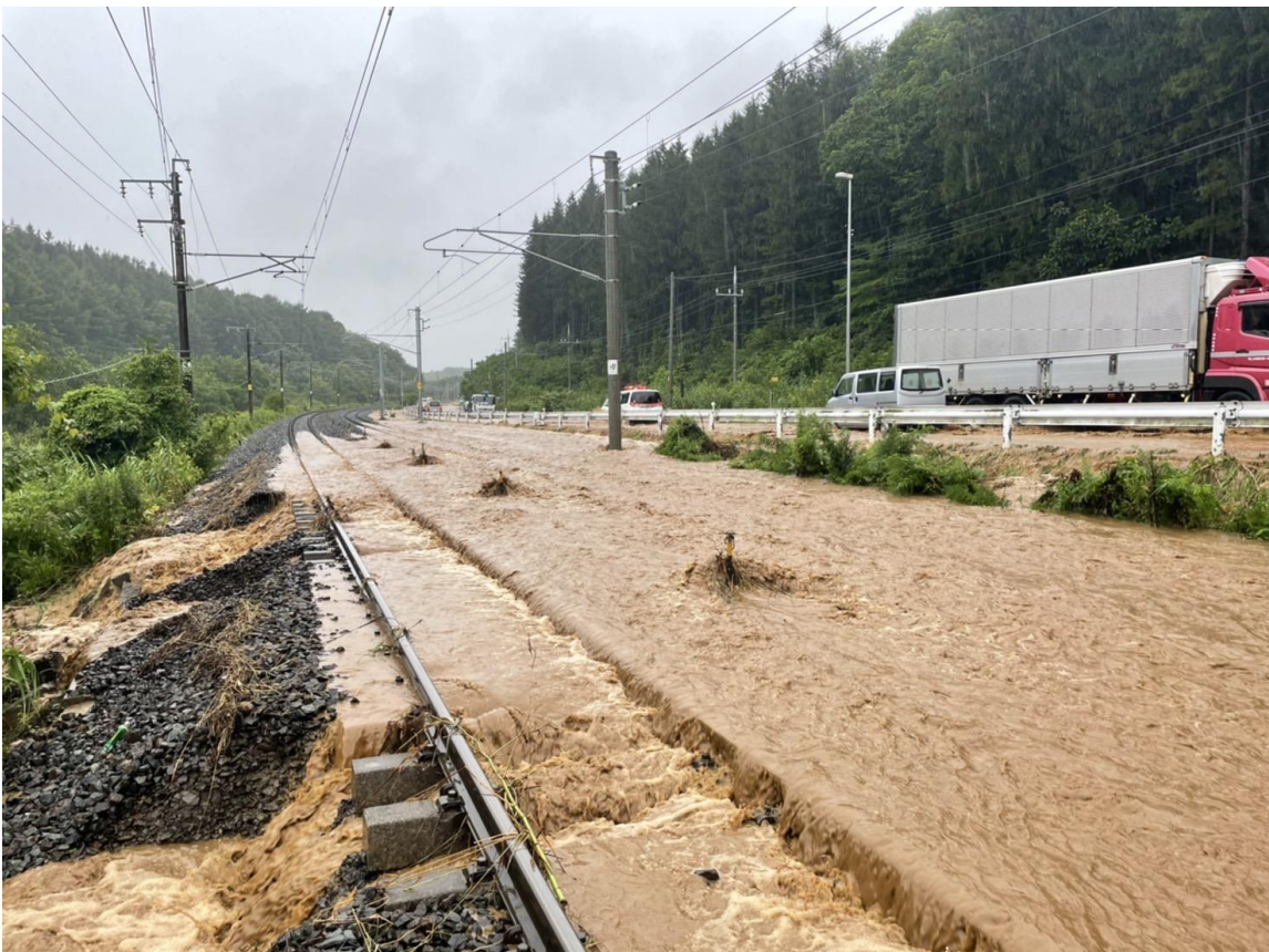
②奥中山高原－小繫間：水による道床流出の様子
