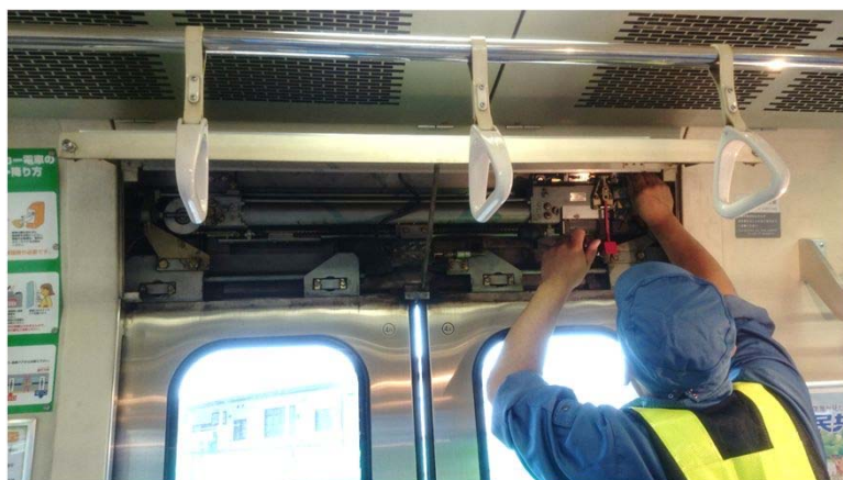
戸閉装置オーバーホール
