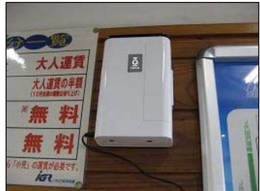
オゾン発生器の設置
