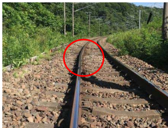
【著大軌道変位状況(2018/8/2)】
