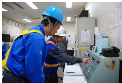
【補助制御盤の取扱い訓練】
