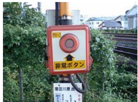
[非常停止ボタン]
