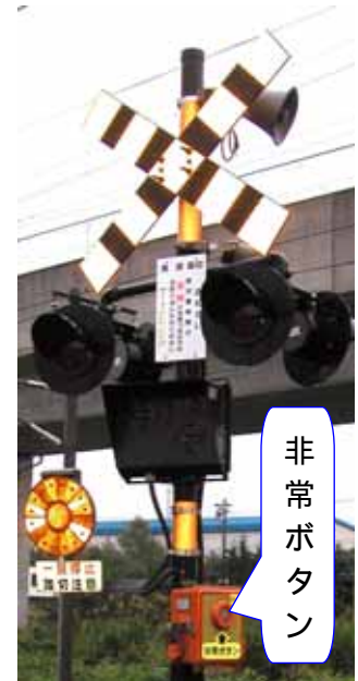
押しボタン式踏切支障報知装置
